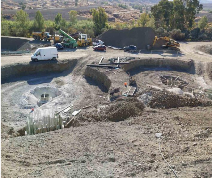
Χωματουργικές εργασίες για τη διαμόρφωση των δεξαμενών δευτεροβάθμιας επεξεργασίας | Earthworks for the formation of the secondary treatment tanks.
