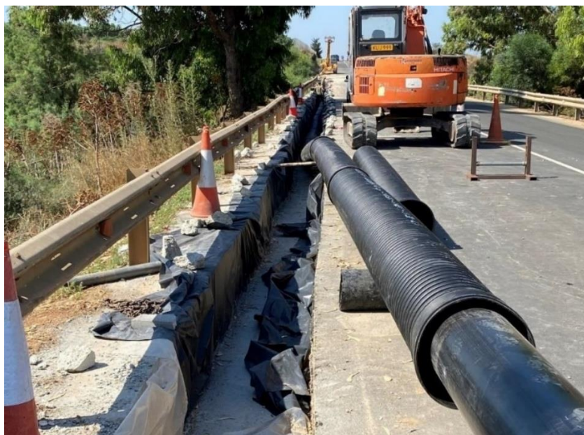
Εγκατάσταση αγωγού άντλησης για τη μεταφορά λυμάτων από την Κοινότητα της Άχνας προς το Σταθμό Επεξεργασίας Λυμάτων | Installation of forcemain for the transport of sewage from the Community of Achna to the Sewage Treatment Plant.
