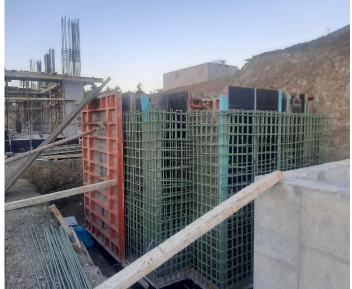
Τοποθέτηση ξυλοτύπων σε τοίχους του κτιρίου τριτοβάθμιας επεξεργασίας | Erection of formwork to the walls of the tertiary treatment building.
