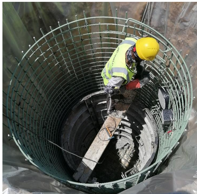
Τοποθέτηση εποξειδικού οπλισμού σε αντλιοστάσιο εντός των δικτύων συλλογής λυμάτων | Installation of epoxy-coated reinforcement in a pumping station within collection systems (lifting station).
