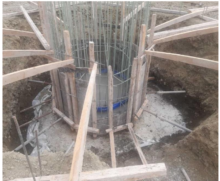
Τοποθέτηση εποξειδικού οπλισμού και ξυλοτύπου σε κώνο φρεατίου του κτιρίου της δεξαμενής αερισμού | Erection of epoxy-coated reinforcement and formwork in a manhole (cone) of the aeration tank building.
