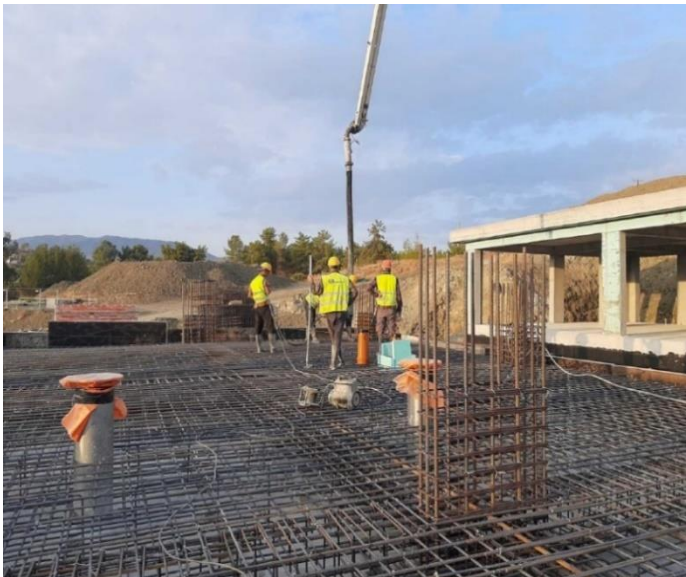
Σκυροδέτηση σε πεδιλόπλακα του κτιρίου προεπεξεργασίας | Concreting the foundation slab of the pretreatment building.
